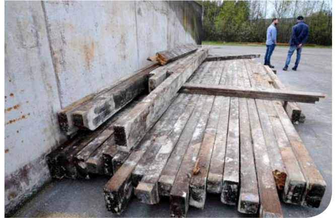
Auch die ehemals tragenden Balken der Fermenter liegen demontiert zum Abtransport bereit.
