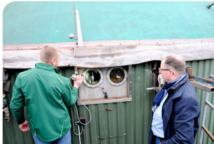
In einem der beiden Fermenter befindet sich nur noch ein Viertel des Füllstandes
